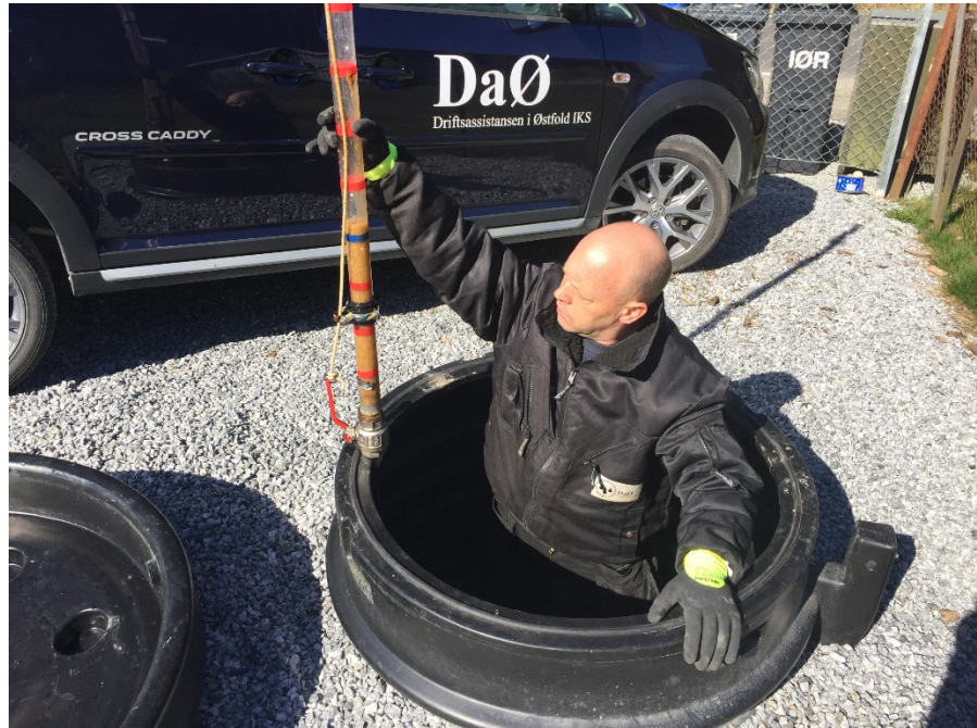
Figur 4. Slamprøverør for måling av slamdybde i et minirensesanlegg.
